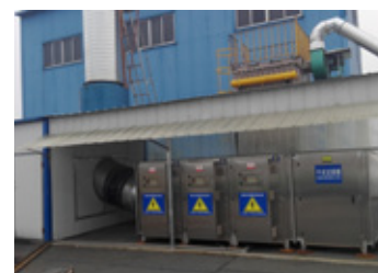
排煙処理装置
