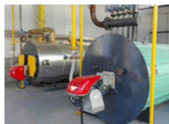
ガスボイラー
