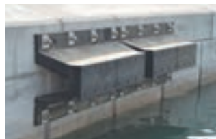
岸壁に設置したV型ソリッド防舷材
