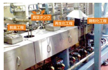
三重工場に導入した量産化設備
