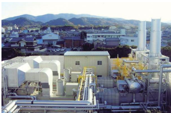
三重工場のコージェネレーションシステム
