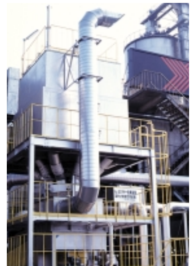
三重工場に設置された大型脱臭装置
