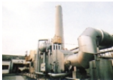
平塚製造所に設置されたコージェネレーション
