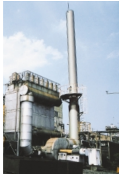
三重工場の廃タイヤ焼却ボイラー
